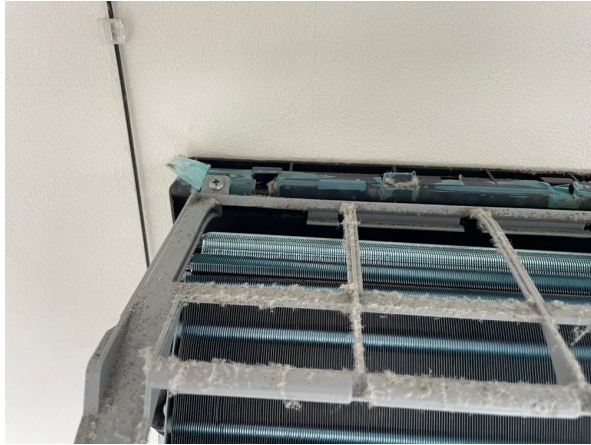
18.エアコンクリーニング
