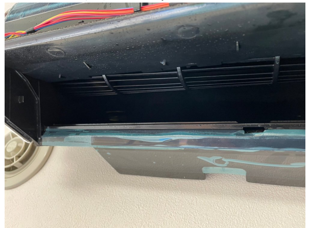
18.エアコンクリーニング
